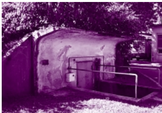
Staro skladišče kemikalij, t. i. bunker, je sanirano in zaklenjeno.
