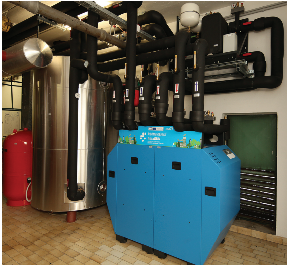
Slika 2: Hladilna naprava in zalogovnik toplote v strojnici stavbe C
