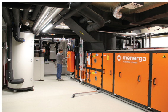
Slika 12: Sodobni prezračevalni sistemi v skladu z zahtevami in standardi za doseganje energetske učinkovitosti ter čistosti zraka v kemijskih laboratorijih
