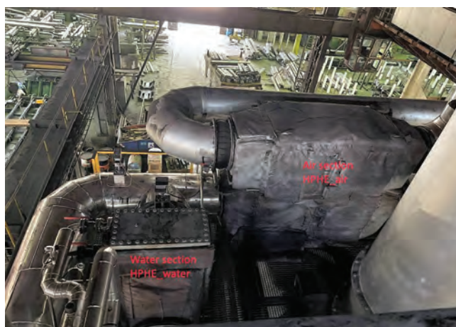
Slika 4: Izvedba pilotne naprave za izkoriščanje odvečne toplote Allino peči v podjetju SIJ Metal Ravne, d. o. o., v okviru projekta ETEKINA
