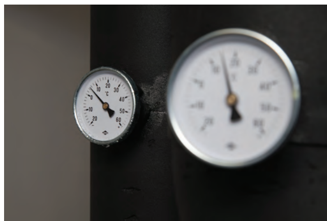
Merilniki temperature vode v sistemu vodnega hlajenja v Računalniškem centru Instituta "Jožef Stefan" na Teslovi
