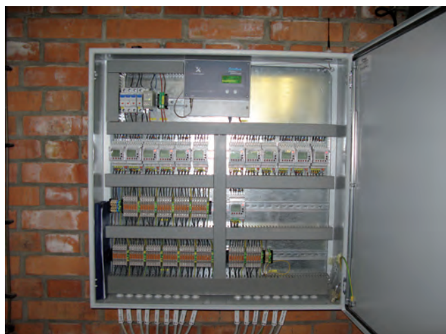
Slika 2: Vgrajena nova merilna in komunikacijska oprema za spremljanje rabe električne energije po objektih RCP IJS
