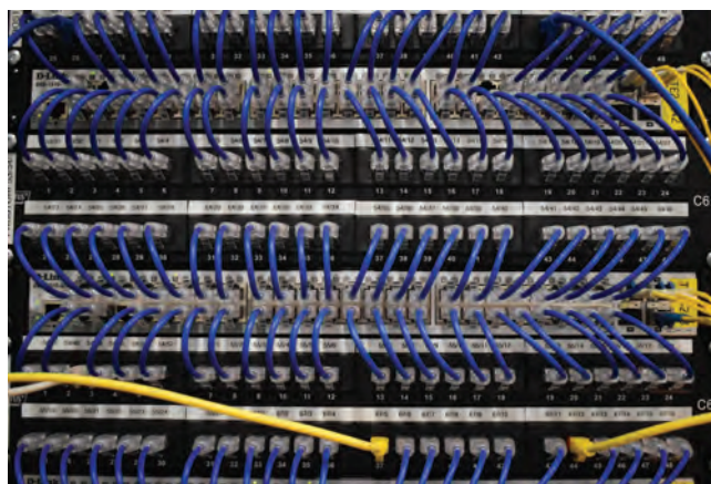
Slika 4: Sodobno kabliranje z uporabo prilagojenih dolžin kablov v mrežnih omarah na Teslovi pomeni lažje vzdrževanje in hitrejše odpravljanje napak.
